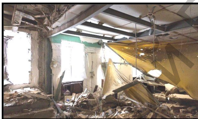
Рисунок 3.6 – Разрушения при взрыве в помещении 66 .
