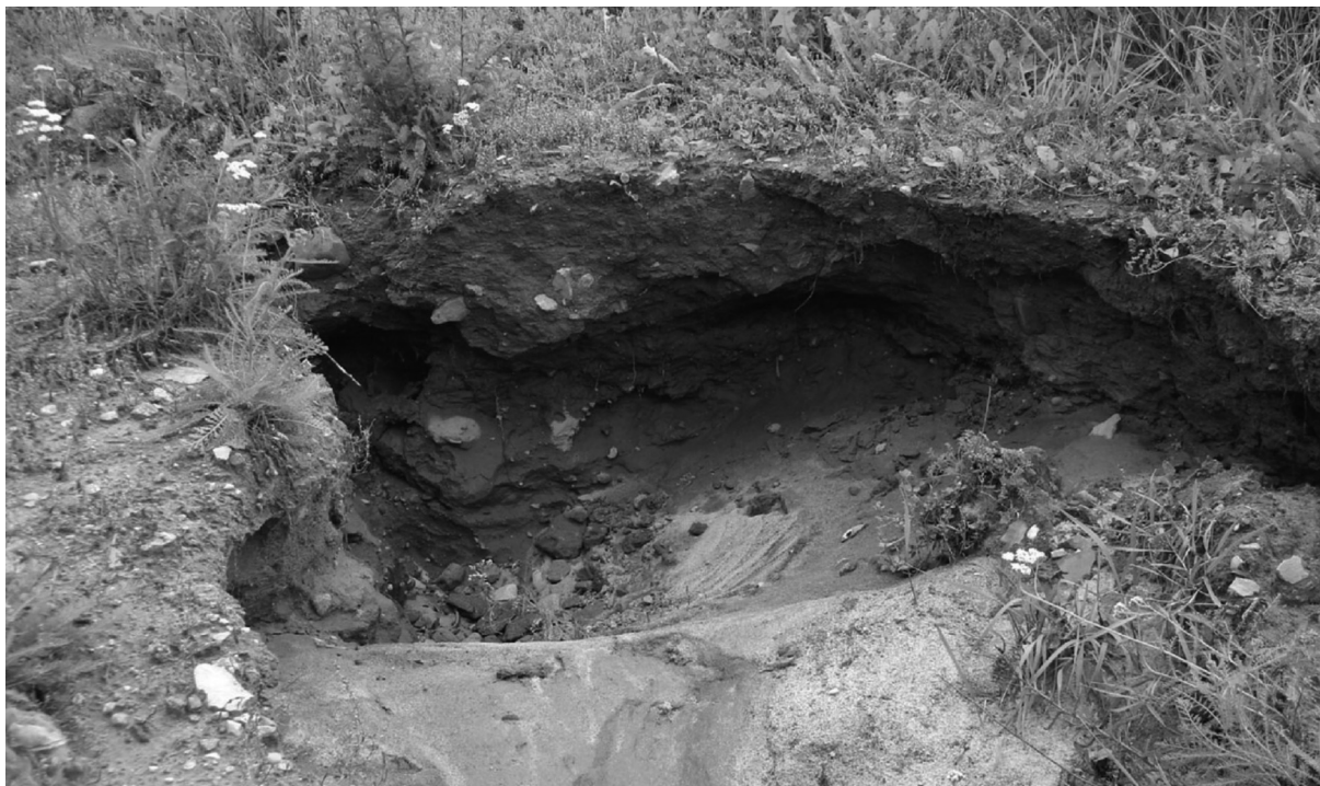
Рис. 2. Суффозионная ниша на склоне оврага Гапеевский в Витебске (2008).
